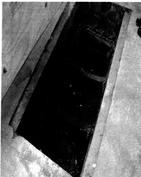
Fosse sous armoires transformateurs
